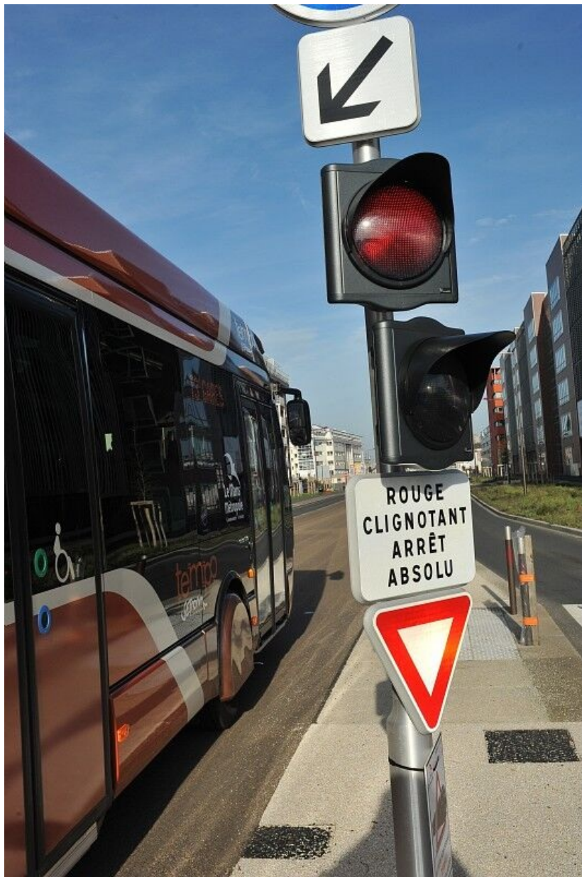
L'installation de la signalisation lumineuse de trafic du bus Tempo, entre Allonnes et Le Mans, a reçu une aide européenne. © Ville du Mans
